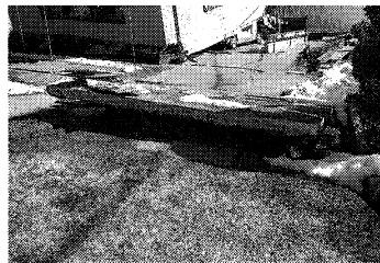
地震により浮き上がった浄化槽（画像は珠洲市内の例）
